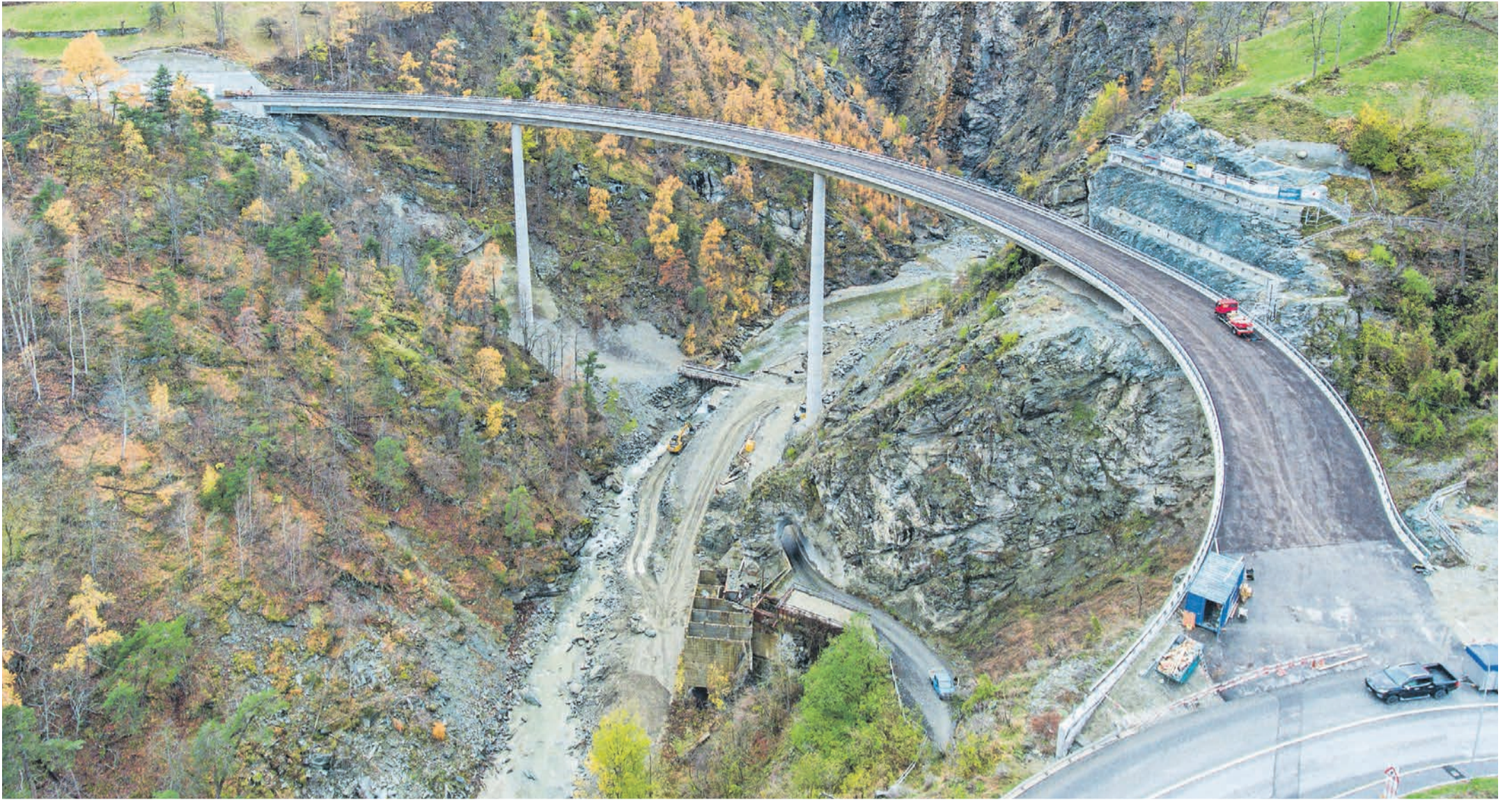
Die Kurve gekriegt. Das Bauwerk fügt sich mit seinen sehr schlanken Pfeilern harmonisch in die tief einschneidende Schlucht der Matternispa ein.
